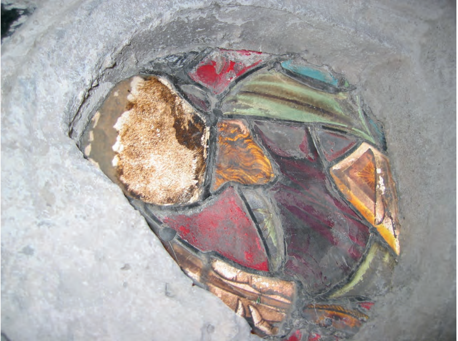
La forma original dels plafons havia desaparegut a causa dels pegats de ciment
