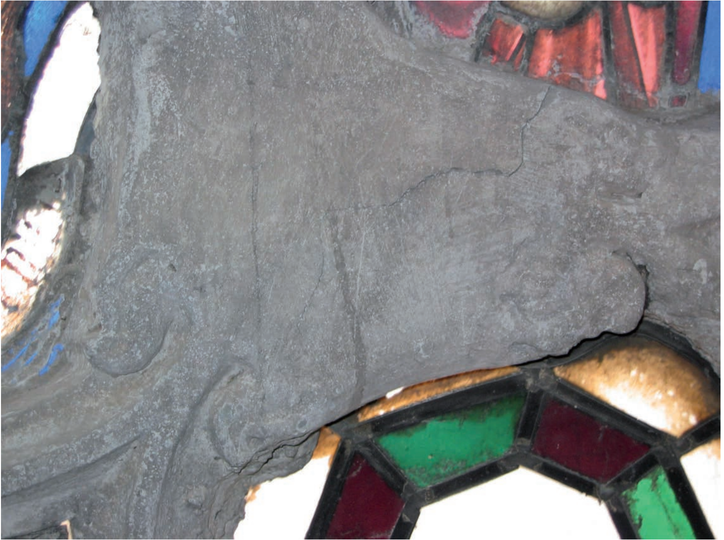
Estat de la pedra amb incorporacions de ciment
