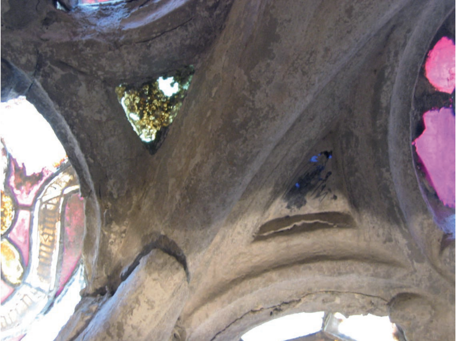
Estat de la pedra abans de la restauració
